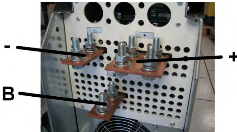
Figura 111: Terminali di potenza
